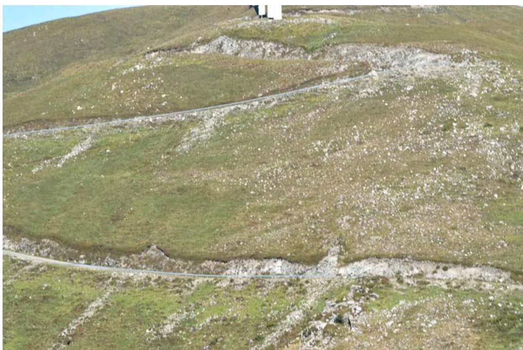
Figura 10.60. Detalle de la erosión vinculada al vial de acceso al Parque Eólico instalado en el Monte Cadramón (año 2022).
