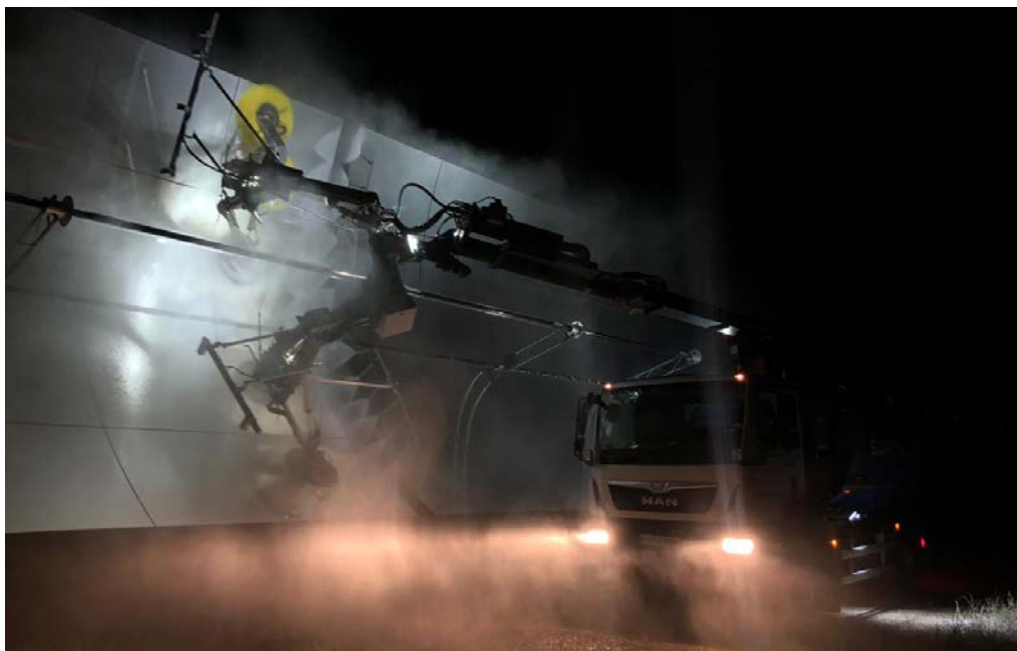
Figura 8.33. Ejemplo de limpieza mecánica en una Planta Termosolar durante el periodo nocturno. Imagen publicada en el Dossier de Trust Ingeniería de Mantenimiento (Olivenza, Badajoz).
