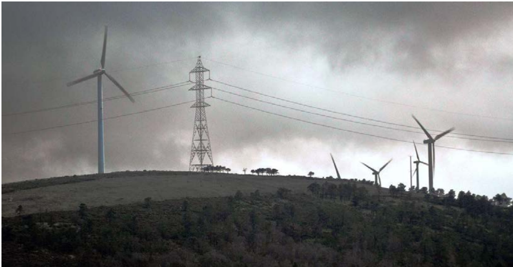
Figura 8.16. Línea eléctrica de alta tensión de Red Eléctrica Española entre San Andrés de Boimente y Pesoz, que con sus 80 km de extensión se emplea para evacuar la energía producida en distintos Parques Eólicos del Norte de Lugo y del Occidente de Asturias
