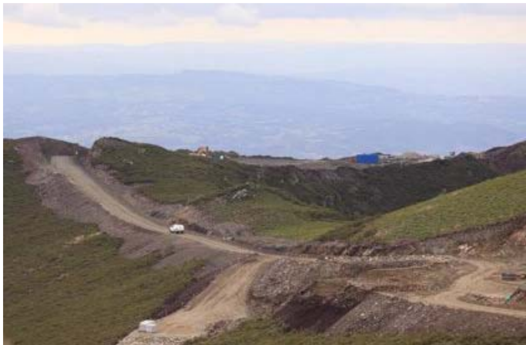
Figura 10.76. Alteración del área de cumbres en la construcción del Parque Eólico de la Serra do Oribio (ZEC Os Ancares – O Courel), integrado en la Reserva de Biosfera Ribeira Sacra. Fotografía: Plataforma Salvemos O Iribio.
