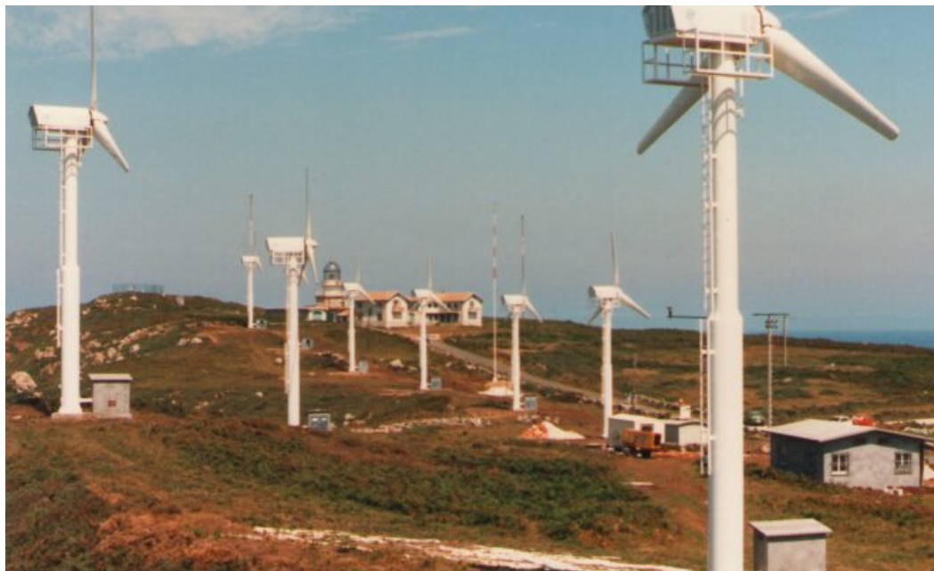
Figura 3.28. Vista general del Parque Eólico de Estaca de Bares (Mañón, A Coruña), designado habitualmente como Parque Eólico de Galicia. Fotografía de Lara Coira publicada en Dinamo (2017).
