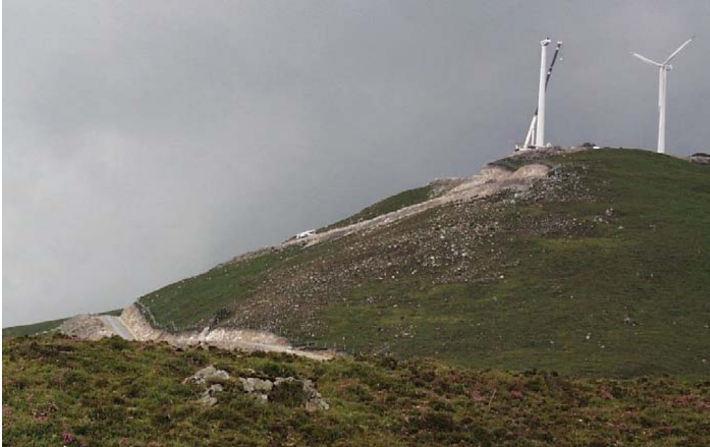
Figura 10.57. Parque eólico en proceso de instalación en 2000 el Monte Cadramón (1.056 m de altitud, O Valadouro, Lugo) donde se aprecia el impacto derivado de las infraestructuras y circulación de maquinaria. Fotografía tomada de Izco & Ramil-Rego, 2001, cuando el área había sido designado pLIC.
